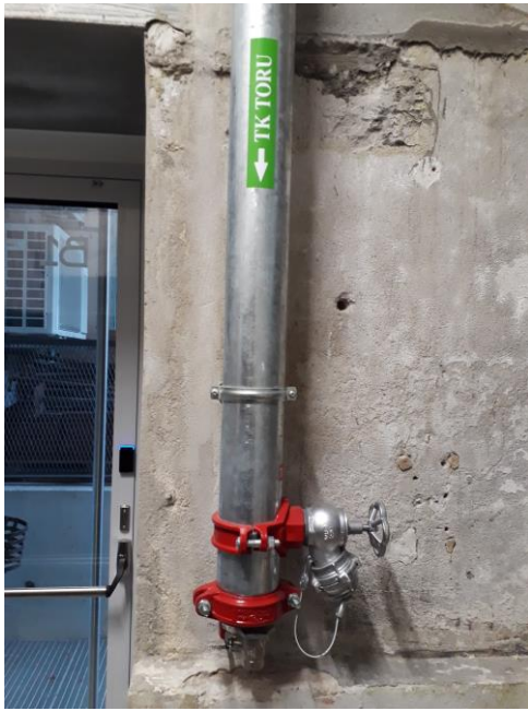
Pilt 28 Ehitisesisese tuletõrjeveevärgi ühenduskoht
